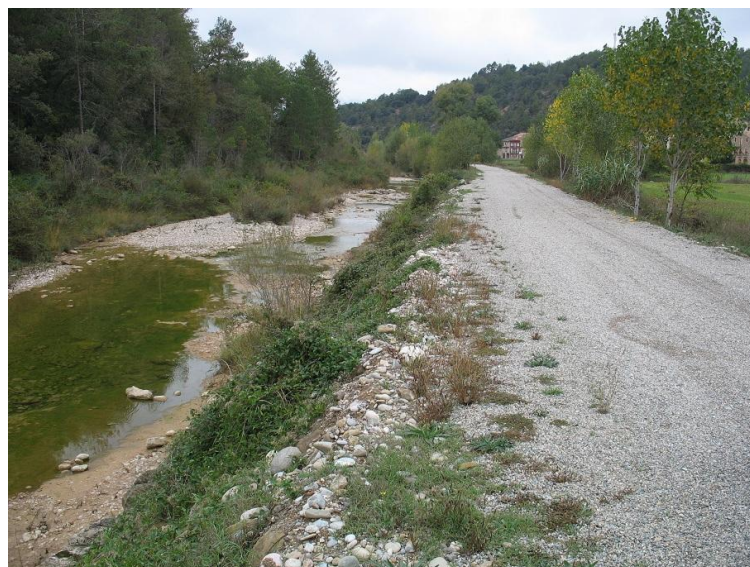
Figura 49-62. Defensa lateral coronada con pista forestal en la localidad de Ogern.
