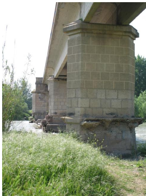
Figura 49-44. Puente con descalzamiento en la localidad de Aitona.
