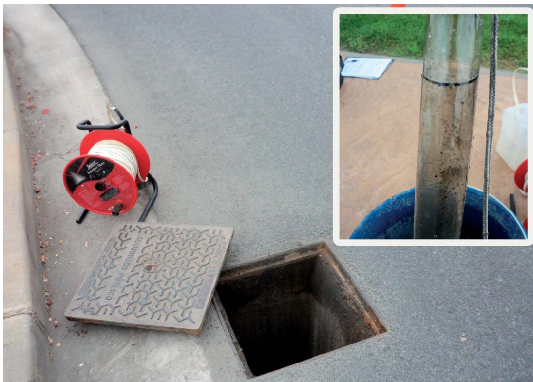
■ FIGURA 5.3.20 PIEZÓMETRO 231010145 LOCALIZADO EN EL FOCO DE CONTAMINACIÓN. DETALLE DE FASE LIBRE (27/06/2012). ZONA 048-02
