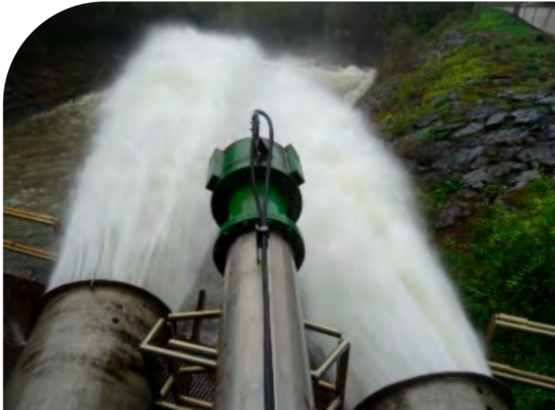
Apertura de los desagües de fondo con el caudal máximo de 8.500 litros por segundo (26/10/2023).
