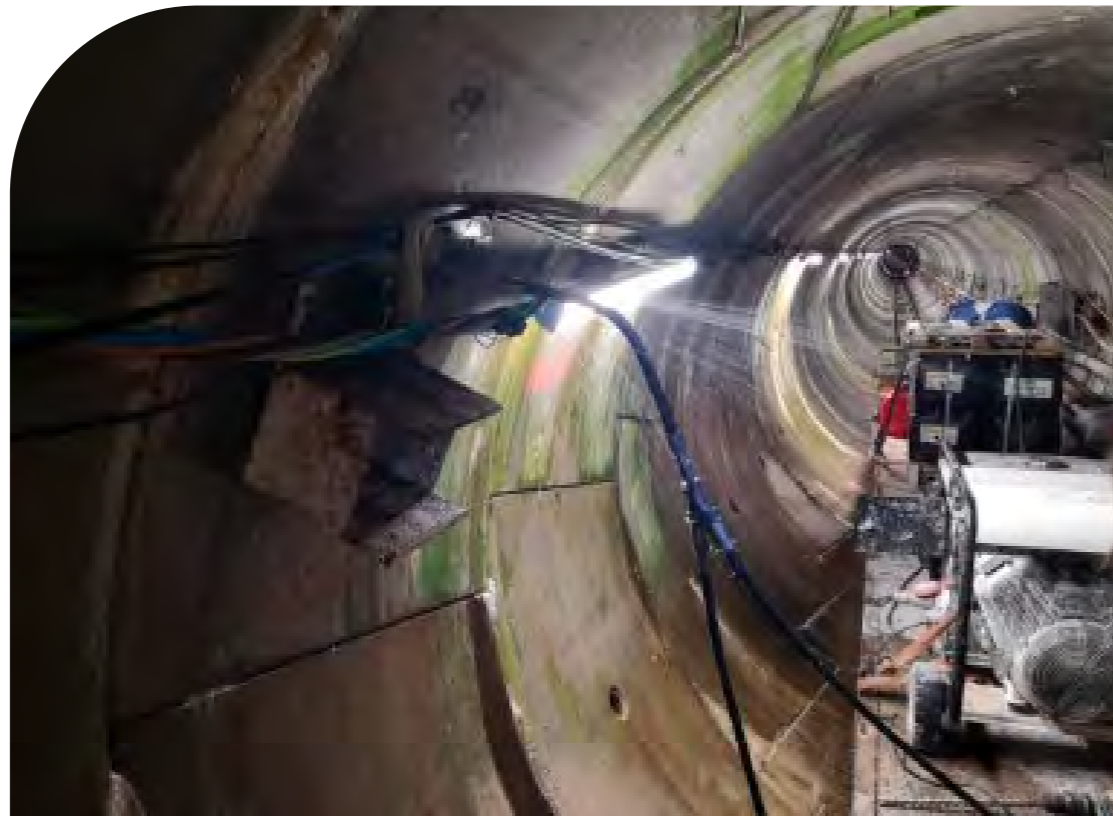
Interior túnel hidráulico Jalón - Grío
