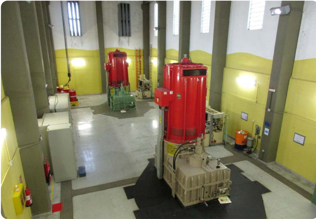
Interior de la central hidroeléctrica de Lodosa (Navarra). Autor: Silvia Cubillo Nielsen (CHE).
