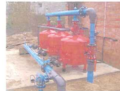
Figura 2.22. Filtres de sorra
