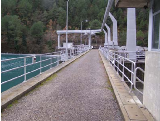
Río Cinca. Azud del embalse de Laspuña para la Central Hidroeléctrica de Laspuña..
