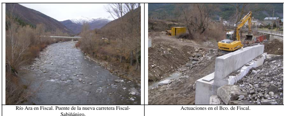
Figura 3.36: Fotos representativas de las características y problemas del Río Ara desde la población de Fiscal hasta el río Sieste. (667).
