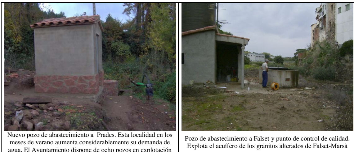
Figura 3.48: Fotos representativas de las características y problemas de la masa subterránea del Priorato
