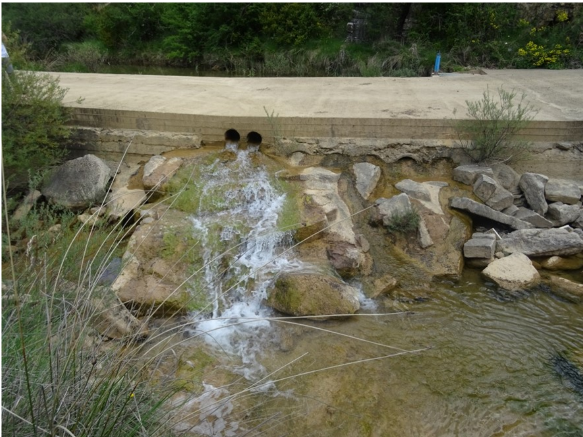
Paso entubado y captación de agua para abastecimiento
