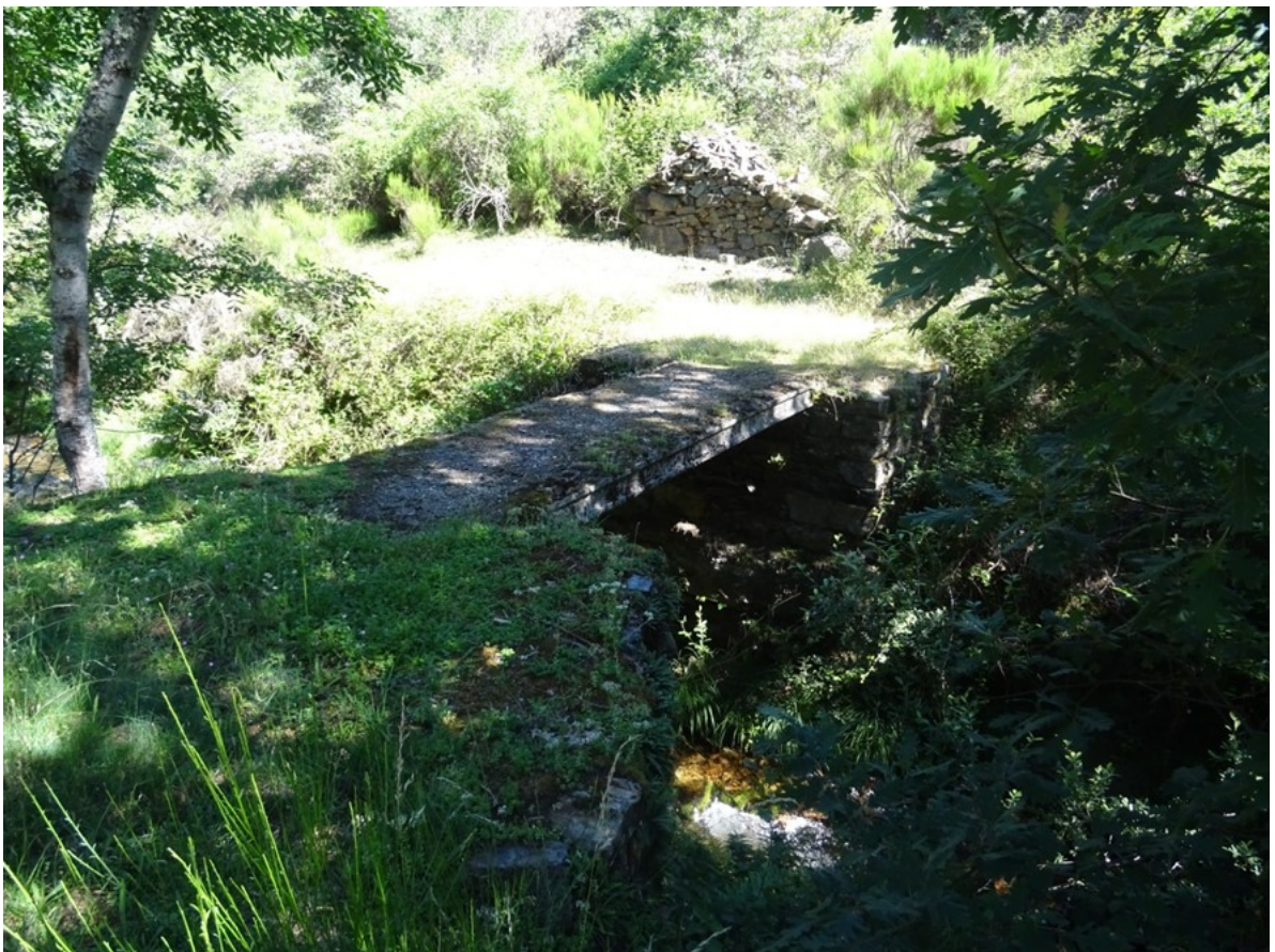
Puente que permite el paso por el sendero a la otra margen del río
